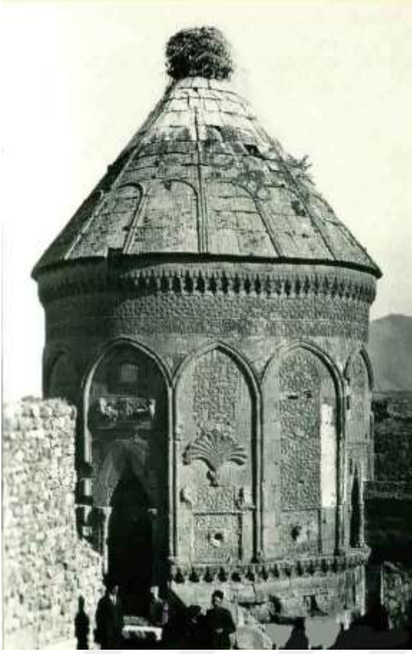
Görsel 2.172. Türbenin onarım öncesi durumu
