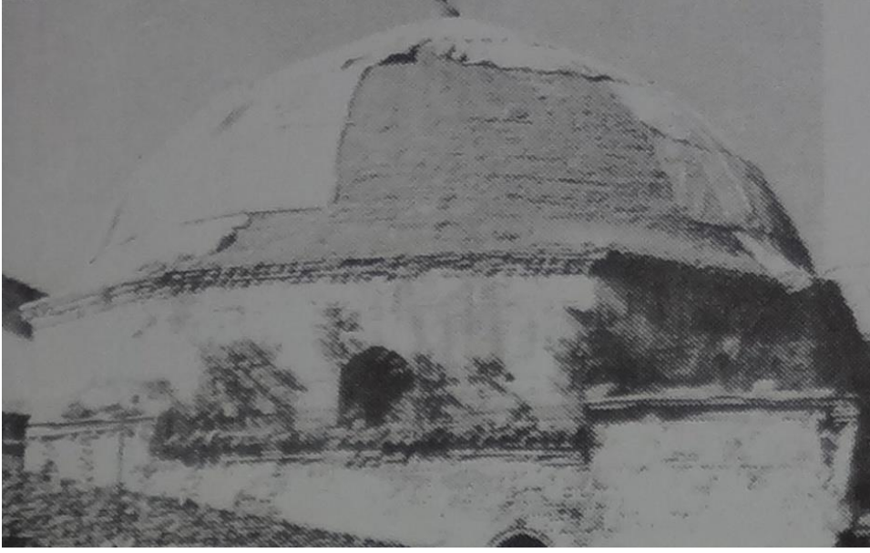
Şekil 7.28: Hocaalizade Camii onarım öncesi kubbenin durumu (Bursa Eski Eserleri Sevenler Kurumu Hizmet Albümü, 1985)
