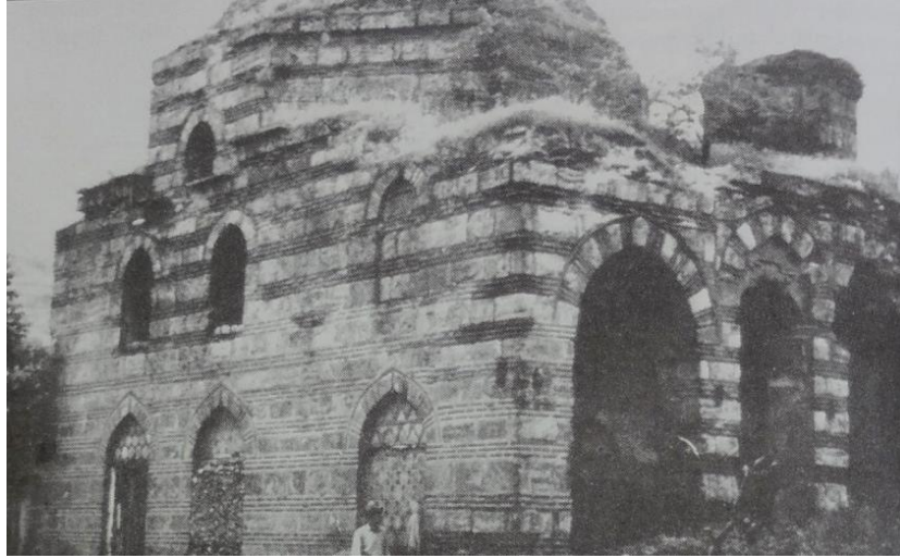
Şekil 7.60: Acem Reis Camii onarım öncesi durumu. (Bursa Eski Eserleri Sevenler Kurumu Hizmet Albümü, 1985)
