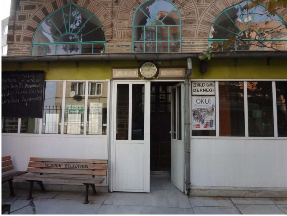
Şekil 7.53: Zeyniler Camii girişine sonradan eklenmiş bölüm. (Keskin, 2014)
