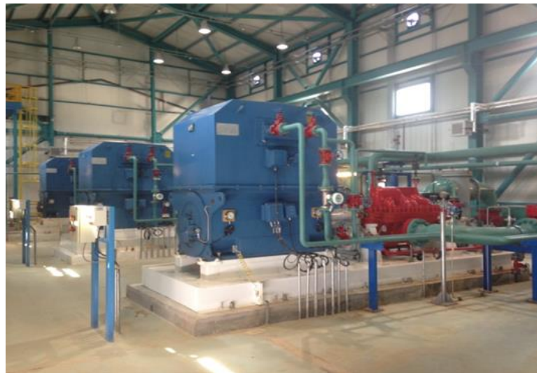
Şekil 4.8: Yüzey tesisleri eritme pompaları.
