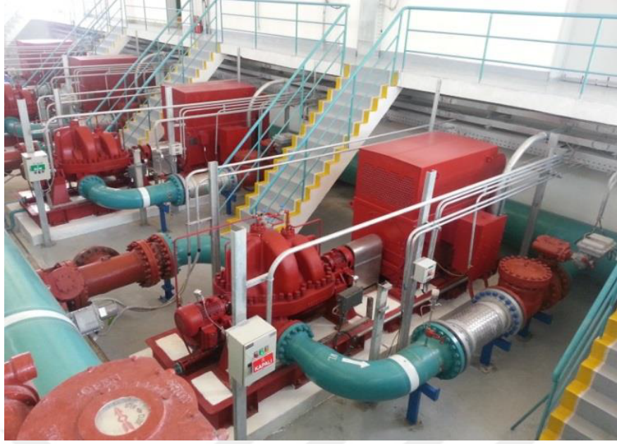
Şekil 2.25. Pompa istasyonu (Bektaşoğlu, 2016).
