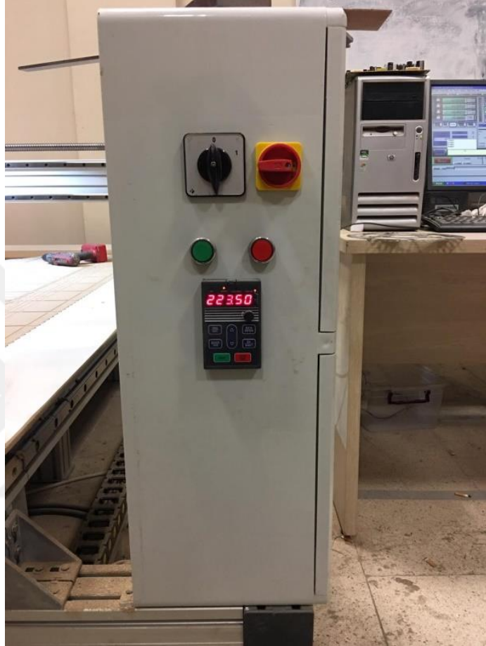
Şekil 4.67 Elektrik Panosu Dış Görünümü
