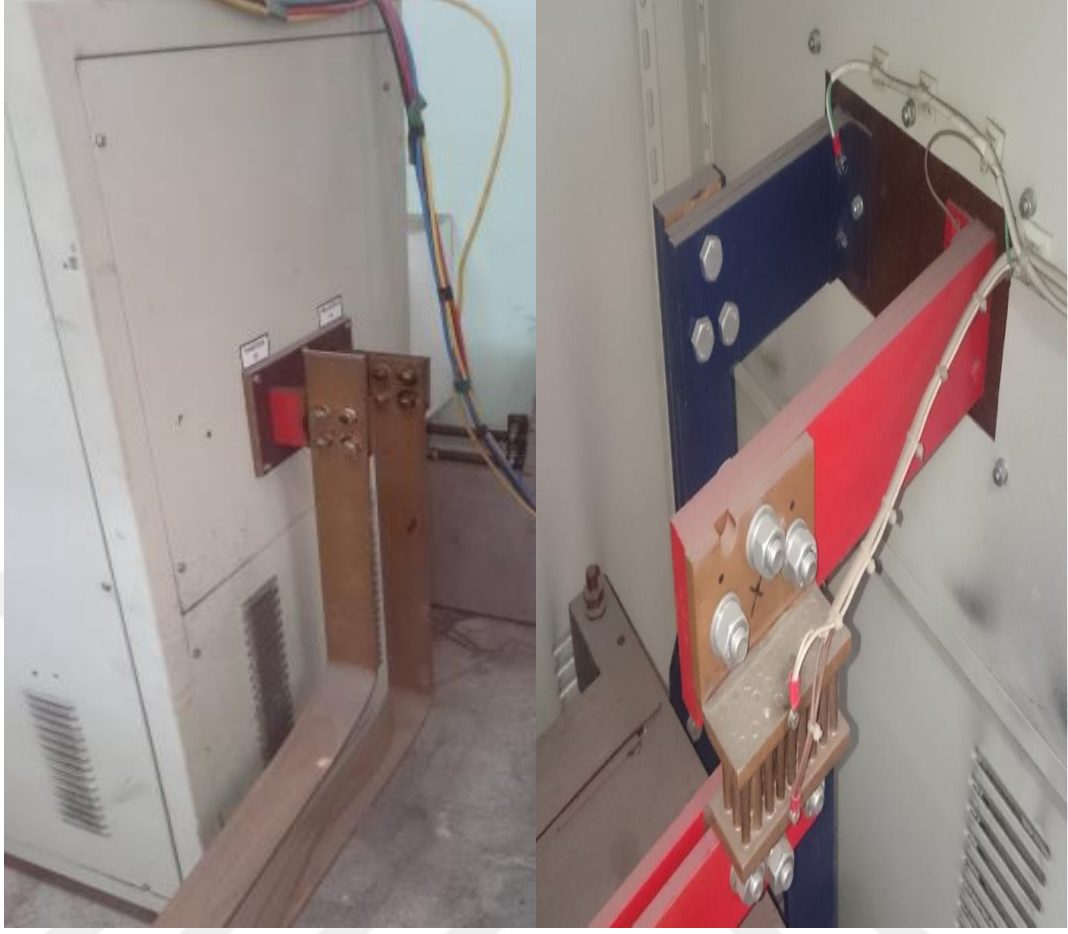
Şekil 4.2. Redresör çıkış baralarının iç ve dış görünümü
