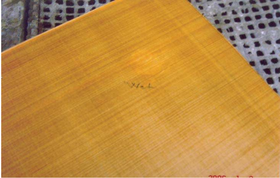
Şekil 7.54 Hasarlandırılarak ıslak serme tamirinin uygulanacağı bölge
