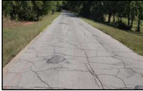
Şekil 3.2. Betondaki donma-çözülme hasarı (Yazıcı, 2014).
