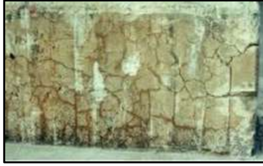
Şekil 3.5. Asit saldırısına uğramış beton (Yazıcı, 2014).
