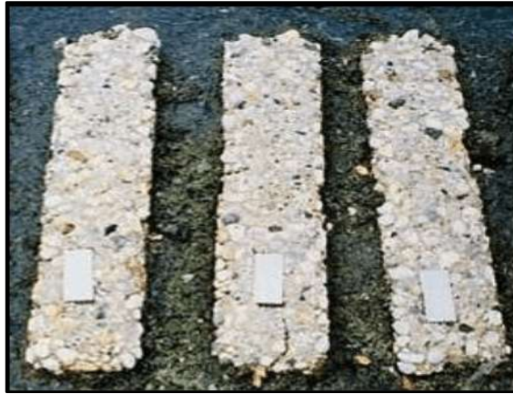
Şekil 3.6. Sülfat saldırısına uğramış normal dayanımlı beton (Yazıcı, 2014).
