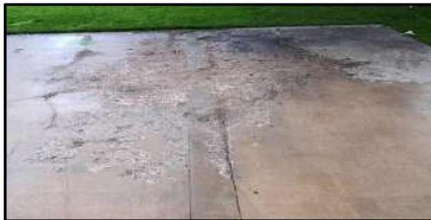
Şekil 3.1. Betondaki aşınma hasarı (Yazıcı, 2014).
