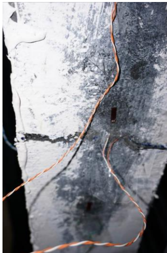
Şekil 3.17 Plaka alt yüzündeki çatlak (Kişisel arşiv, 2016)
