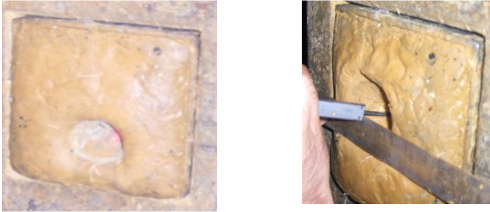
Resim 3.10 Arka kısım dolgu malzemesinde meydana gelen deformasyon.
