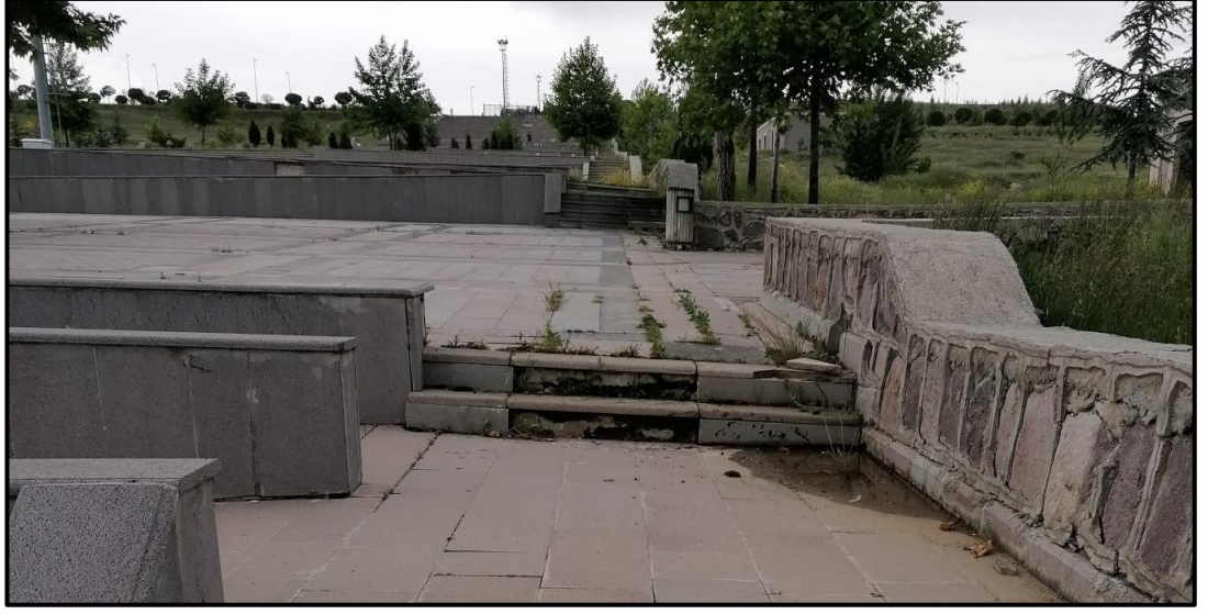
Şekil 5.2 ÇAKÜ Uluyazı Kampüsü deforme olan merdivenler
