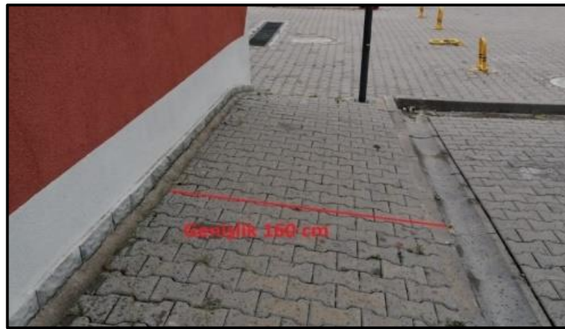
Şekil 4.24 ÇAKÜ Uluyazı Kampüsü Hukuk Fakültesi bina çevresi kaldırımını - 1
