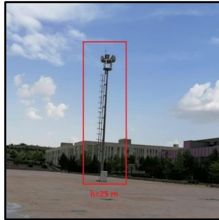
Şekil 4.66 ÇAKÜ Uluyazu Kampüsü toplanma alanındaki yüksek aydınlatmalar
