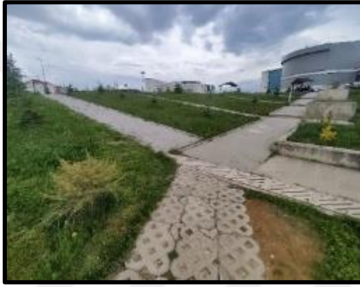
Kütüphane Binası Çevre Düzenlemesinde Bulunan Döşeme Farklılıkları
