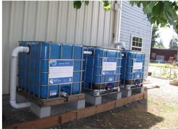
Şekil 28. Yer Üstü Yağmur Suyu Depolama Tankı
