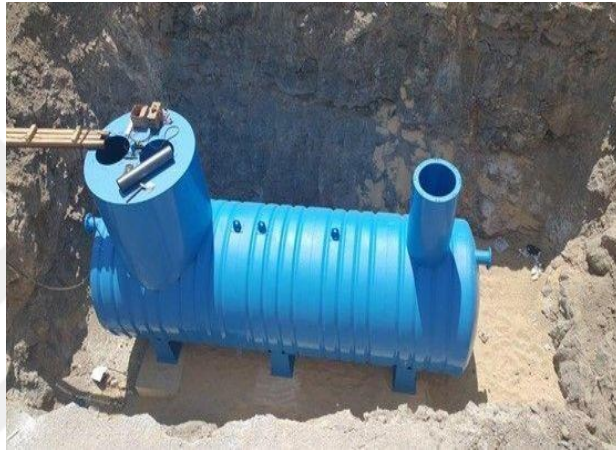
Şekil 27. Yer Altı Yağmur Suyu Depolama Tankı
