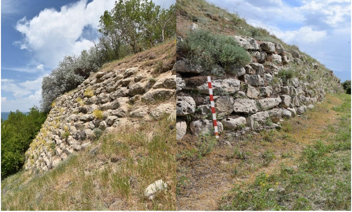
Resim 7. 22. Minua (Şamram) Kanalı Destek Duvarlarında Görülen Eğim Farkı
