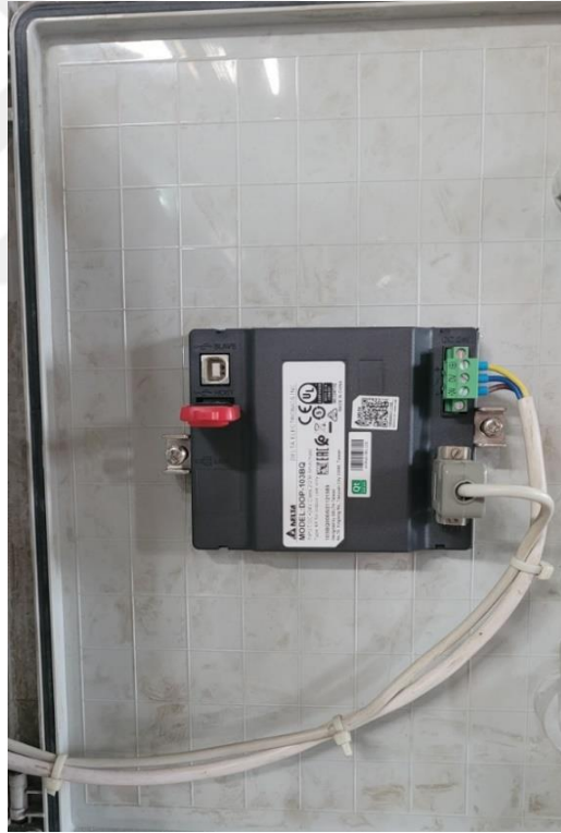
Şekil 3.9. Data logger detay görünümü.
