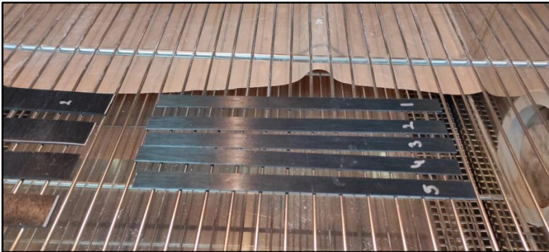
Resim 3.9. İklimlendirme cihazı içerisindeki kupon malzeme görüntüsü
