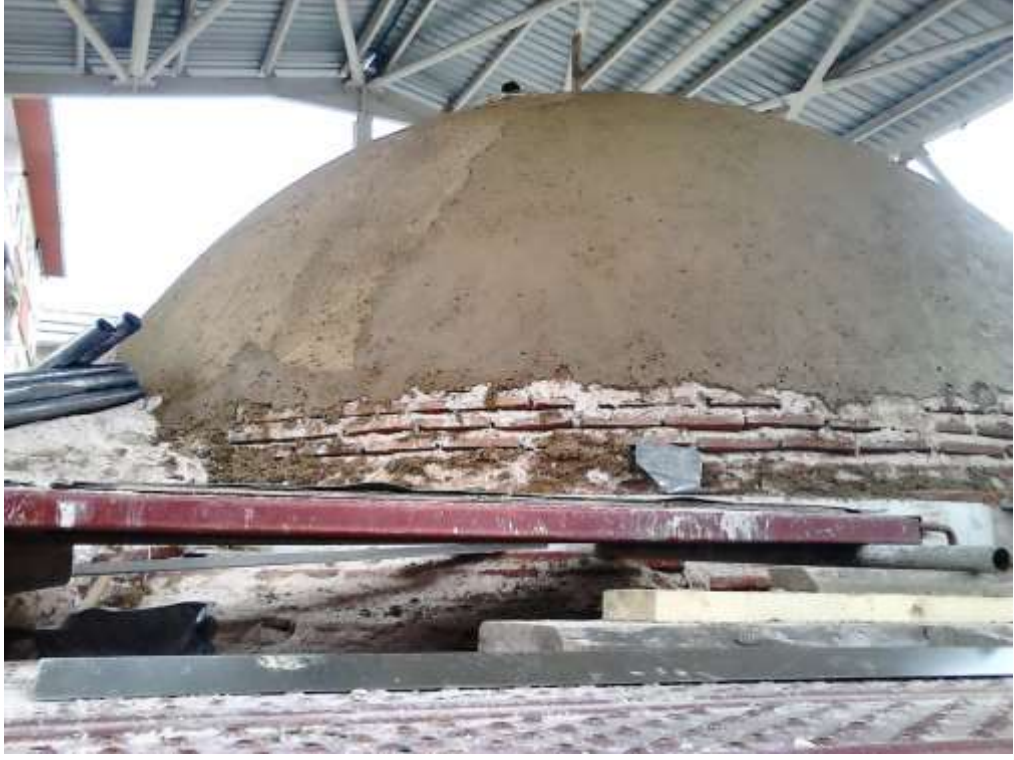
Şekil 8.18. 2013 yılı onarımı sırasında tuğla kubbe sıvanması.
