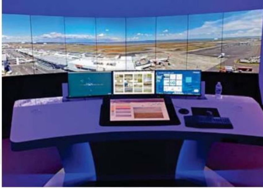
Şekil 2.8. Budapest,Papa ve Debrecen havalimanlarının eş zamanlı uzaktan kontrolünü sağlayan uzak kontrol kule merkezi [17]
