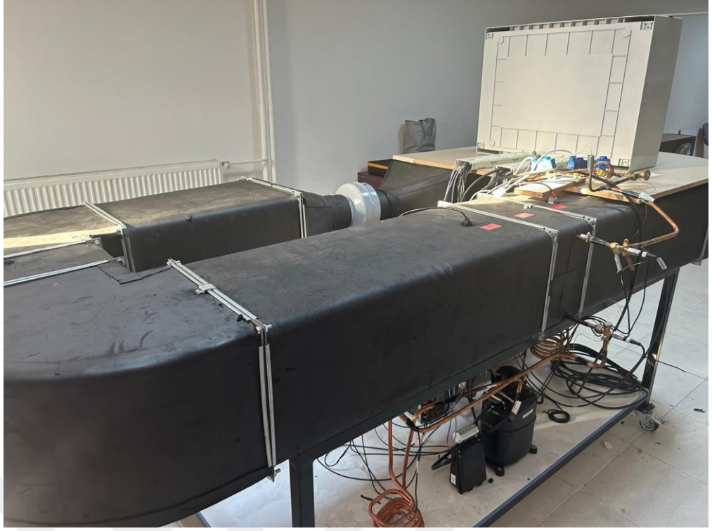
Şekil 4.2. Soğutma sistemine ait genel görünüm.
