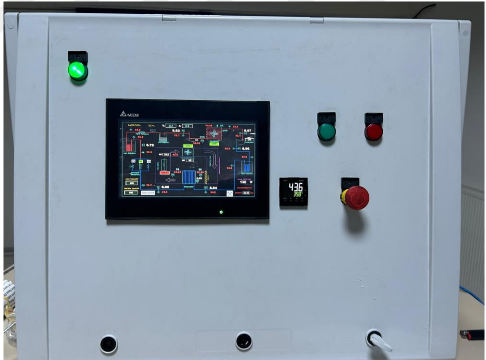
Şekil 4.5. Kontrol sistemi panosu dış görünümü.
