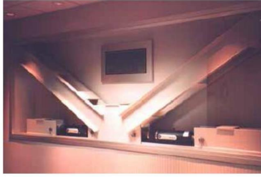
Şekil 17. Kurulumu tamamlanmış viskoz sönümleyici
