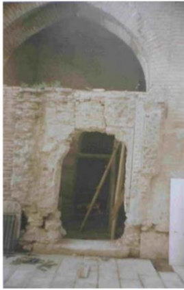
Şekil 4.21. Giriş kapısının onarım öncesi durumu (Yavaş, 2010)
