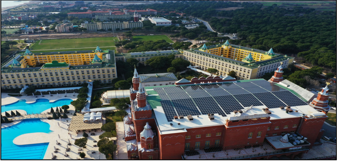
Şekil 2.6 Antalya’da bir otel çatısına kurulmuş bir fotovoltaik güneş enerji sistemi.
