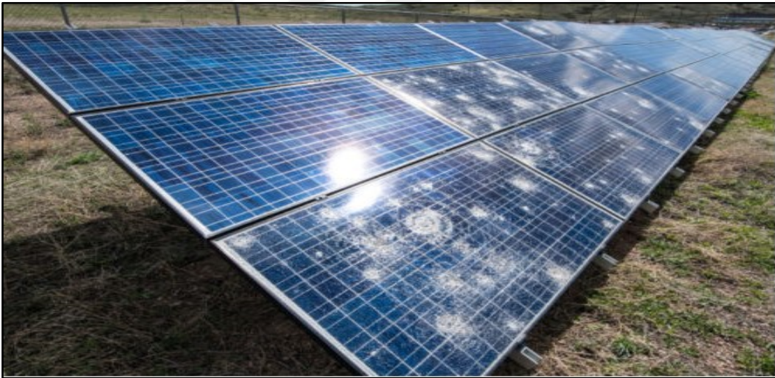
Şekil 2.10 Doludan zarar görmüş bir arazi tipi fotovoltaik güneş enerji santrali.
