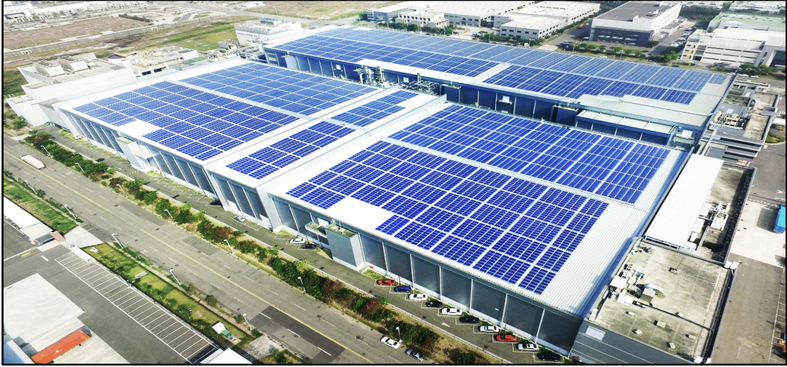
Şekil 2.8 Büyük bir endüstriyel tesis çatısına kurulmuş bir fotovoltaik güneş enerji sistemi.
