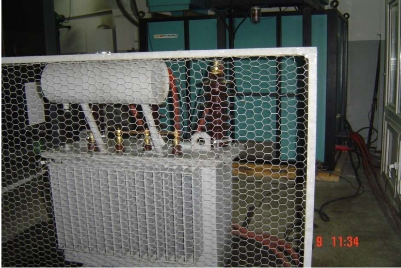
Resim 3.2. Dağıtım transformatörü test alanında
