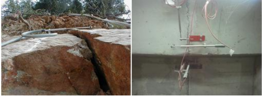
Şekil 5.6. Çatlak, derz ölçer (Alçay, 2014).
