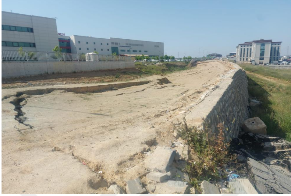
Şekil 6.2. Çalışma noktalarımızın yakınındaki yol üzerinde meydana gelen deformasyon.
