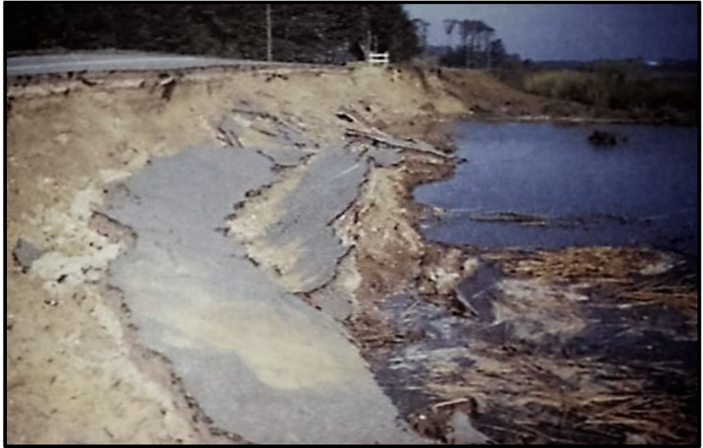
Şekil 2.8. Merced Gölü kıyısında meydana gelen akma sıvılaşması San Francisco sıvılaşması (Mollamahmutoğlu ve Babuçcu 2006)
