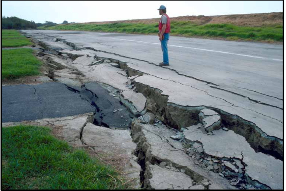
Şekil 2.7. Akma sıvılaşması sebebiyle hasar görmüş yollar (Anonim 2017b)
