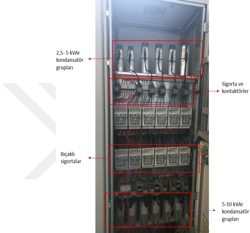
Şekil 5.28. Merkezi araştırma laboratuvarı kompanzasyon panosu
