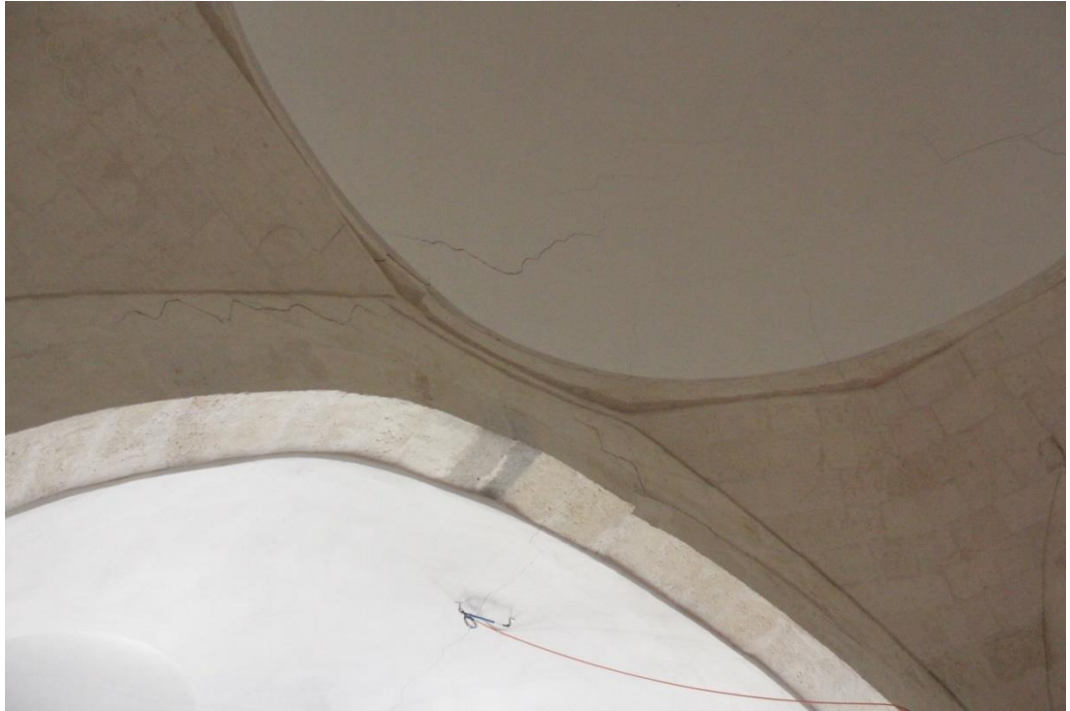
Şekil 2.8. Caminin kemer ve kubbesinde meydana gelen çatlaklar.
