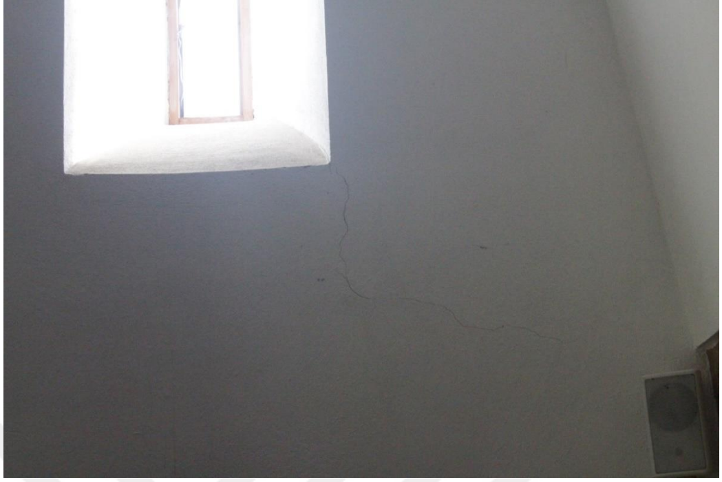
Şekil 2.9. Caminin pencere boşluğundan başlayan çatlaklar.
