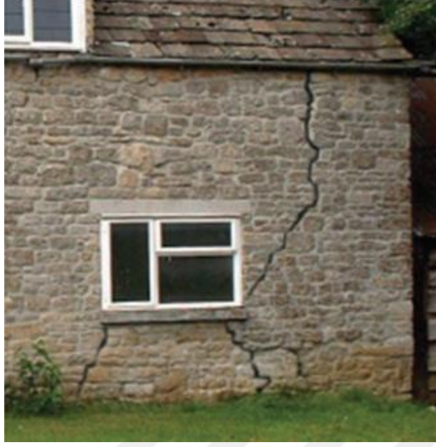
Şekil 3.2. Oturma çatlağı (URL-1).
