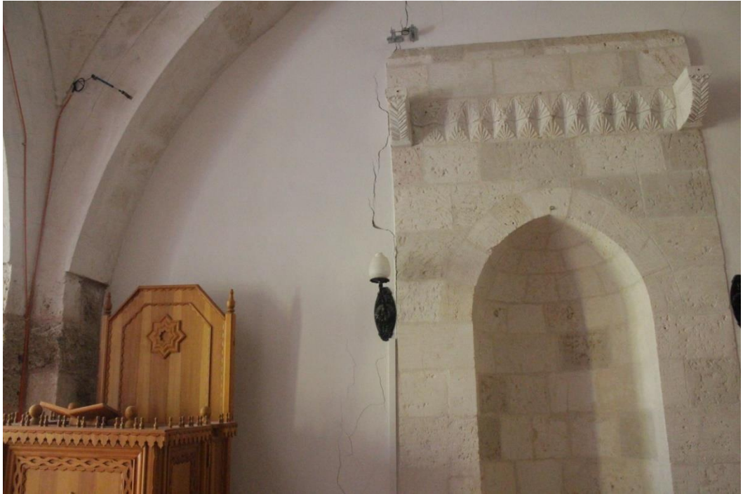
Şekil 2.10. Caminin mihrap kısmında meydana gelen çatlaklar.
