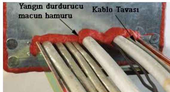
Şekil 4.33: Kablo etrafına uygulanmış yangın durdurucu macun hamuru [4]
