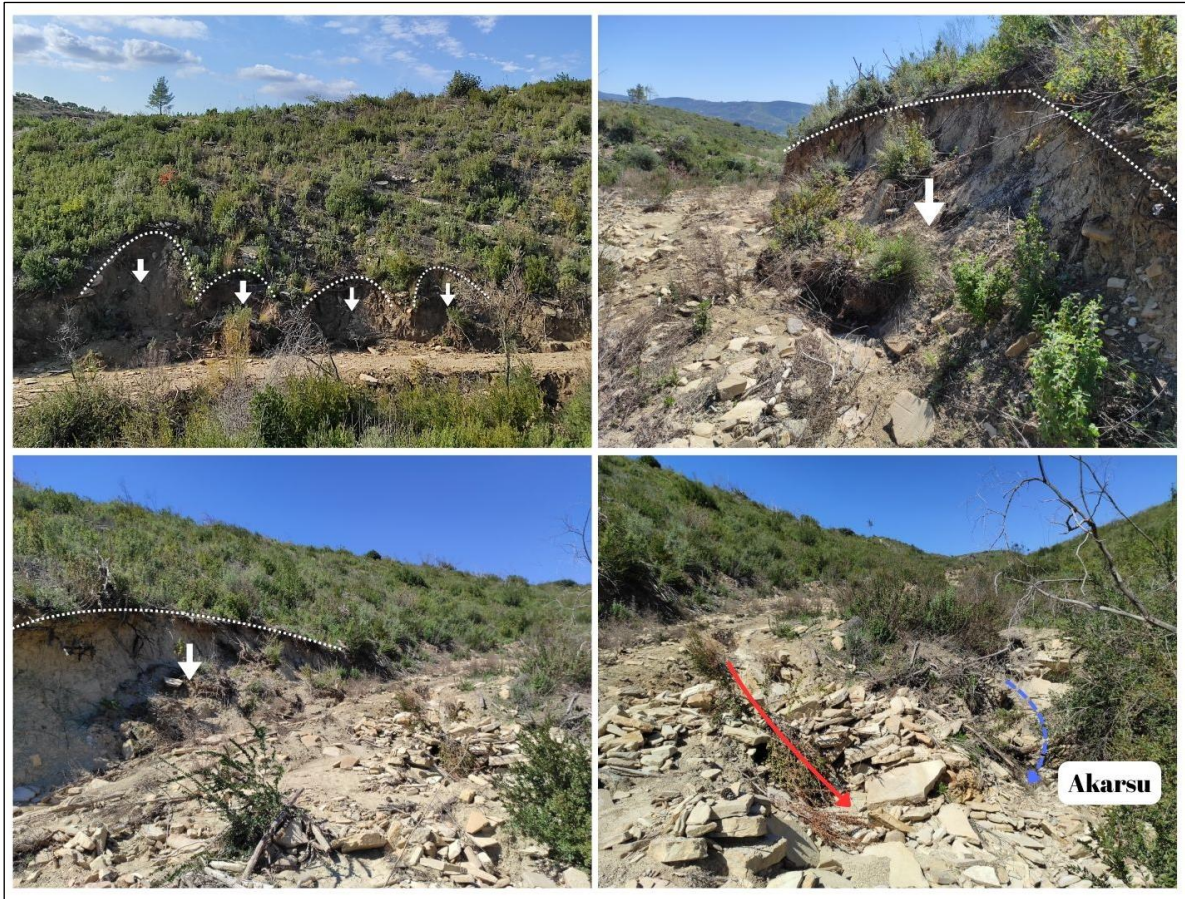
Fotoğraf 4.5 Üretim Faaliyetleri Kapsamında Oluşturulan Yol Yarmalarındaki Şev Çökmesi ile Orman Yolu ile Akarsu Arasındaki Hidrolojik Bağlantıyı Gösteren Görseller (YADG-H2)
