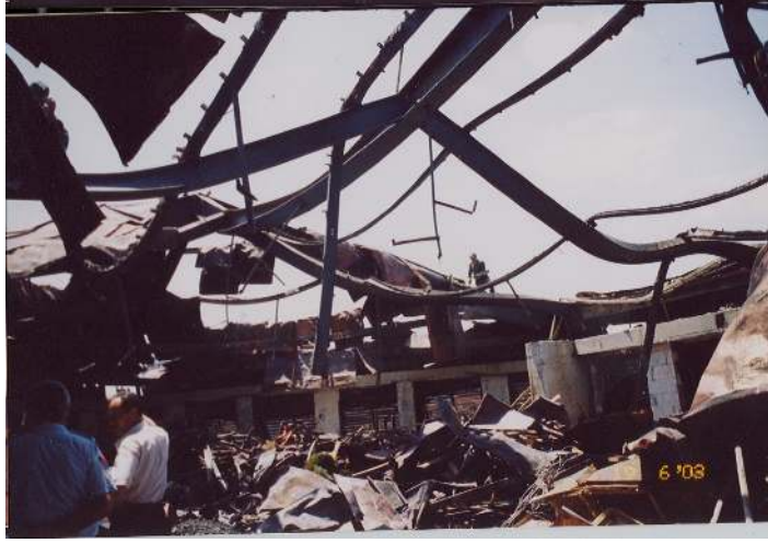
Resim 4.1. MNG Hizmet Binası 10. katının yangından sonraki hali
