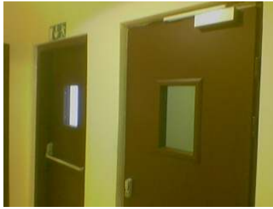
Resim 4.2. Zemin katta bulunan 90 dakika dayanımlı yangın kapıları
