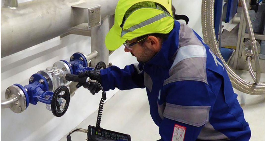
Şekil 3.5. Buhar kapanı (kondestop) testi.
