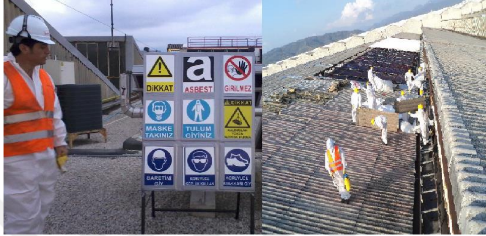
Şekil 5.22 Asbest sökümünün gerçekleştirildiği bir bölgede bulunan uyarıcı tabelalar (Yeşilyurt, 2016)
