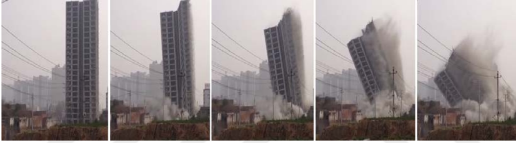
Şekil 17. Yapının devrilirken kendi içerisinde göçerek yıkılması
