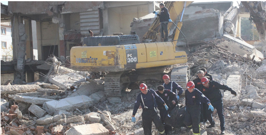
Şekil 10. Denizli’deki yıkım kazası
