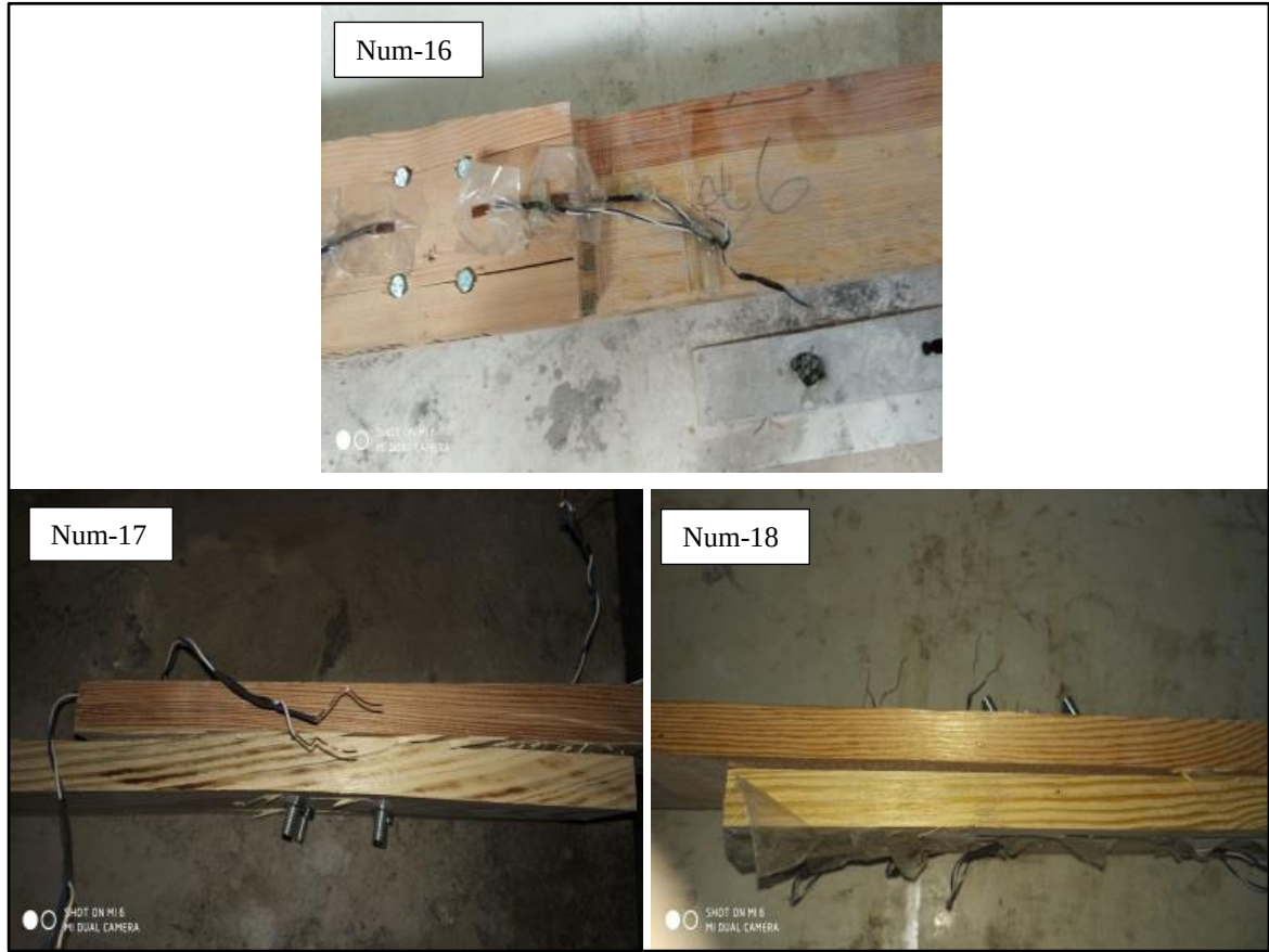
Resim 4.6. Numune 16,17 ve 18'in göçme mekanizmaları
