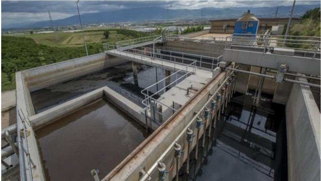
Şekil 3.7. Çöp suyu arıtma tesisi genel görünümü
