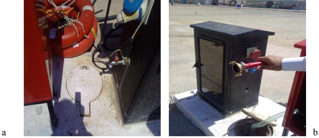
Şekil 4.32. Kaş yat limanı atıksu alım noktası
