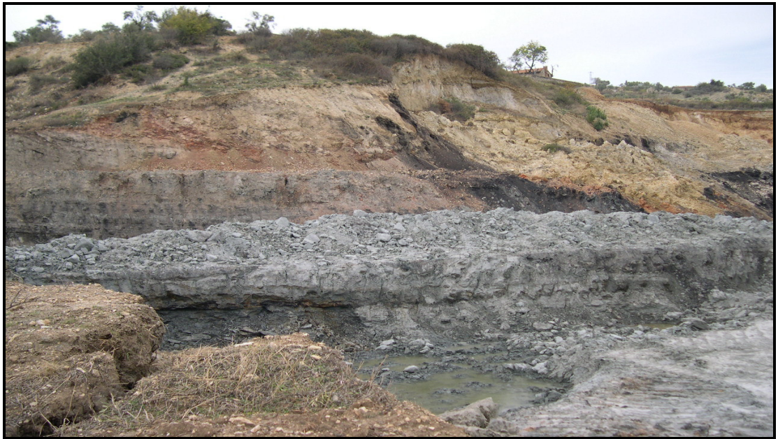
Foto 16: Bağıyaka Hafriyat Sahası Heyelan Risk Alanı
