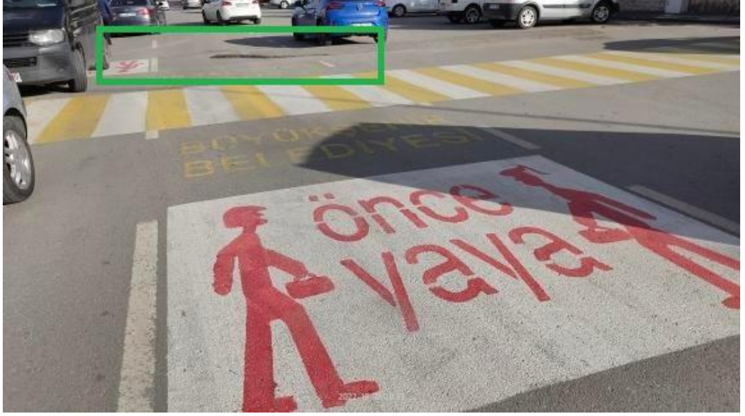
Şekil 4.11. Okul yaya geçidi öncesinde yerleştirilmiş olan hız kesicinin zamanla bir kısmının tahrip olması ve bu şekilde yayalar için risk oluşturmaması.
