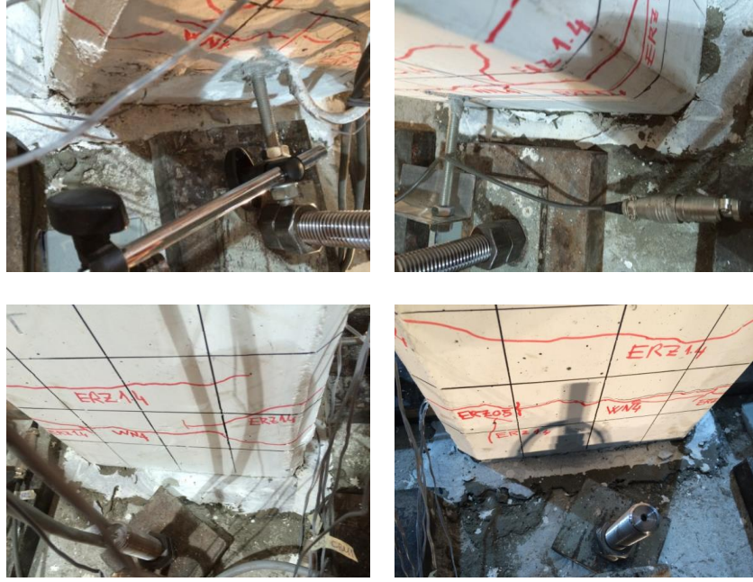
Şekil 3.63 : ERZ1.40 testi sonrasında kolon ile temel arasına yerleştirilen harçta meydana gelen çatlaklar.
