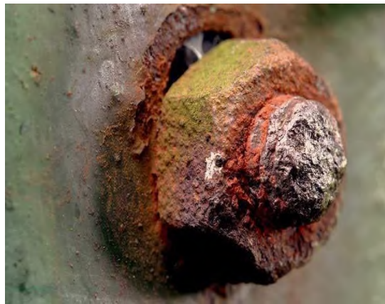
Şekil 1.7 Korozyona uğramış somun-cıvata
