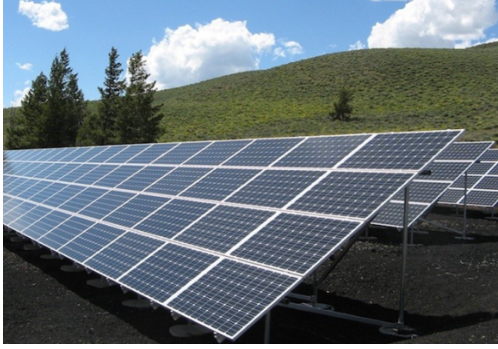
Görsel 2.1. Fotovoltaik Paneller
