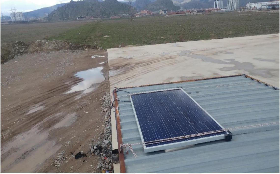
Şekil 4.2 Proje konteynırı üzerine monte edilen solar panel.
