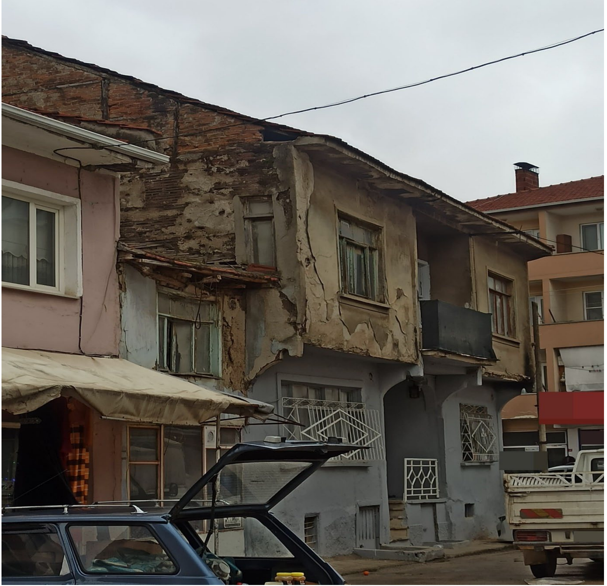
Fotoğraf 3.4 Ulucami Mahallesinde Bulunan İçerisinde Yaşamın Bulunduğu Risk Taşıyan Bina
