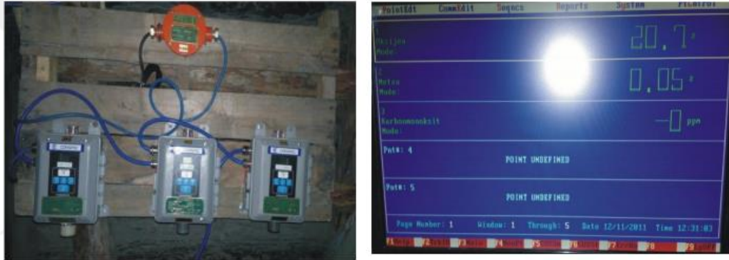
Şekil 5.4 Erken uyarı sistemi algılayıcı sensörleri ve gaz izleme ünitesi (Mallı ve ark.,2014)
