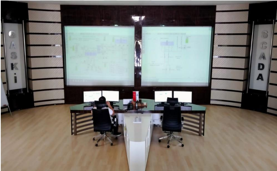
Şekil 5- 5: Scada Sistem Odası [51]
