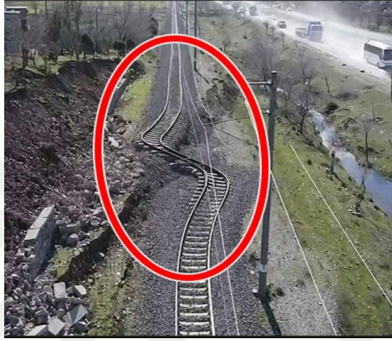
Resim 3.2 6 Şubat 2023 Kahramanmaraş Depremi'nde raylar depremin şiddetiyle 'S' çizdi. (İnt.Kyn.15)
