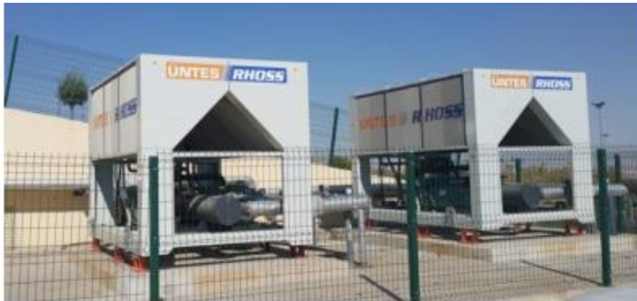
Şekil 3.13. KBBM soğutma üniteleri
