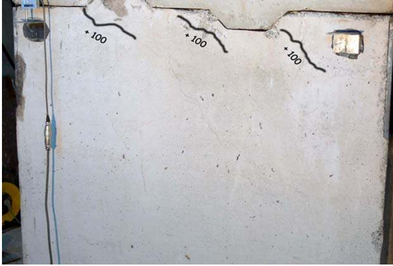
Resim 4.11. 100kN yük altında oluşan çatlaklar
