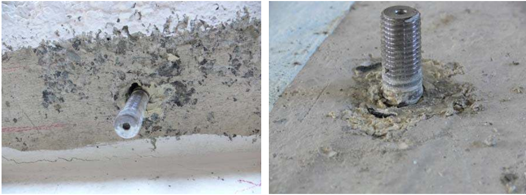
Resim 4.8 Deney sonrası hatıl betonunun birleşim yeri görünümü
