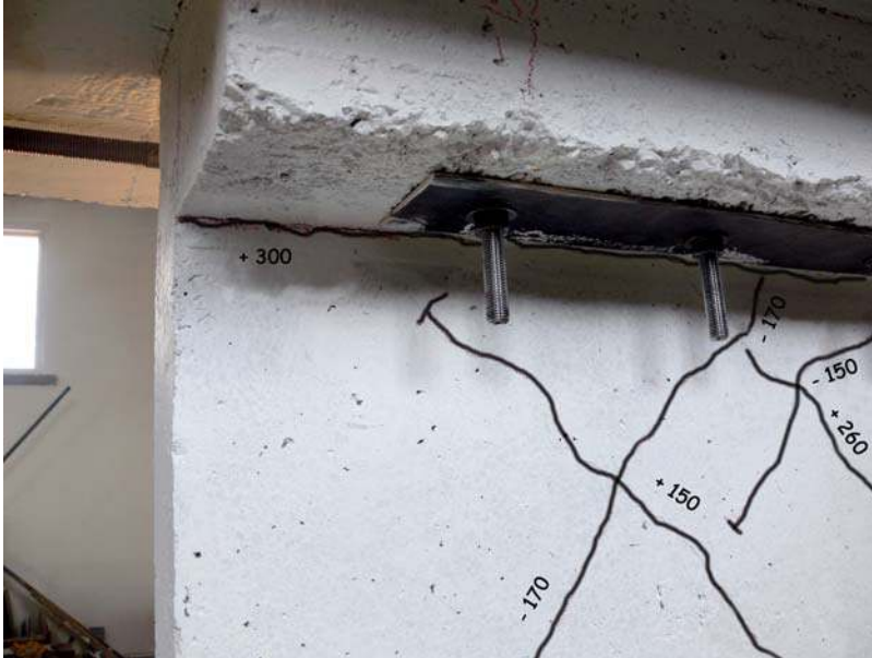
Resim 4.6. 300kN'da oluşan çatlaklar
