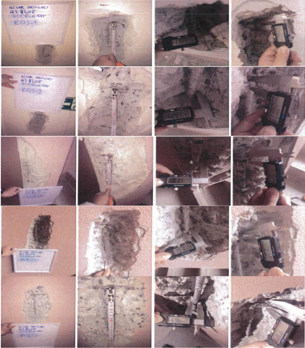
Şekil 23. Belirlenen kolon, kiriş ve perde elemanlara ait yapılan sıyrma işlemleri ve donatı korozyonu belirlenmesi için yapılan sıyrma işlemleri
