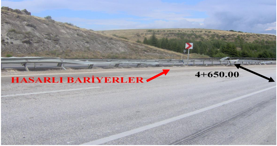
Resim 4.1: Üçüncü Kurb Üzerinde Hasar Görmüş Bariyerler
